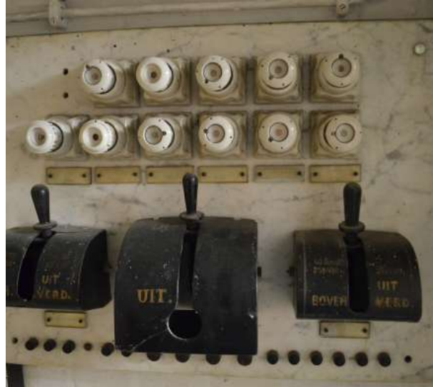
Ook de schakelaars zijn nog origineel ...
