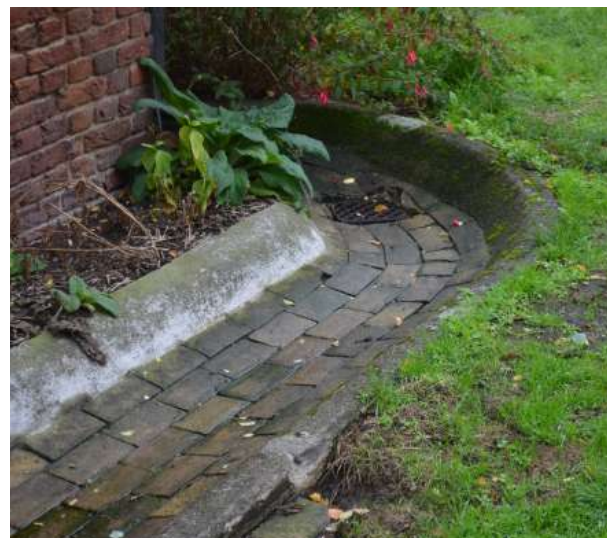
Het rieten dak watert af in een gemetselde brede, holle goot rondom het huis.
